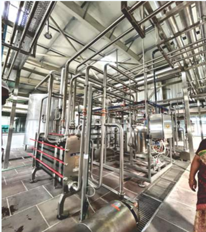
करीमनगर एमपीसी में 1.5 लाख लीटर क्षमता का दही प्लांट (प्लांट के अंदर का दृश्य)
